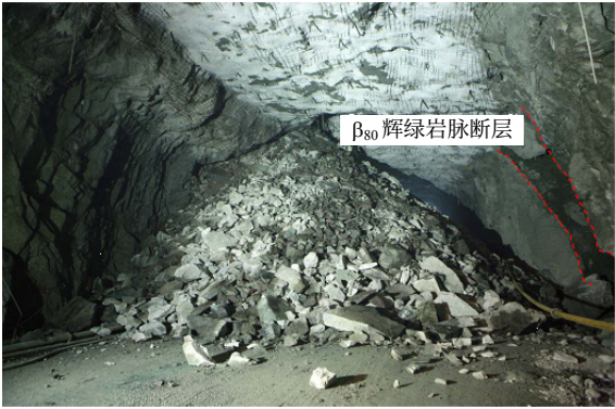
图 2 岩脉断层处的拱顶塌方区 Fig.2 Collapse area on the dykes fault
