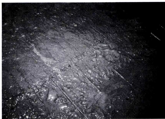
图1 底板露筋典型照片
